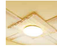
32 照明器具全室
